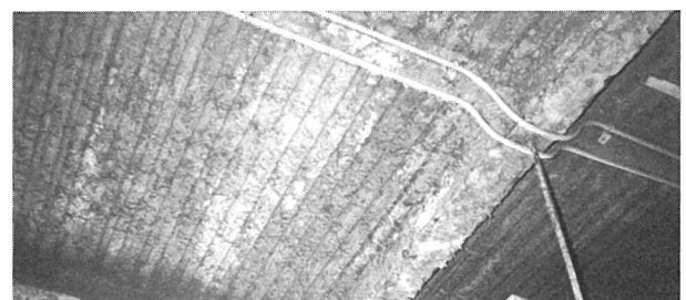
車庫の天井に吹き付けられた石綿 所々に剝落がみられる
